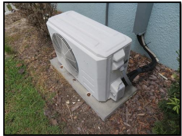
Figure 2 - Mini Split Condenser
